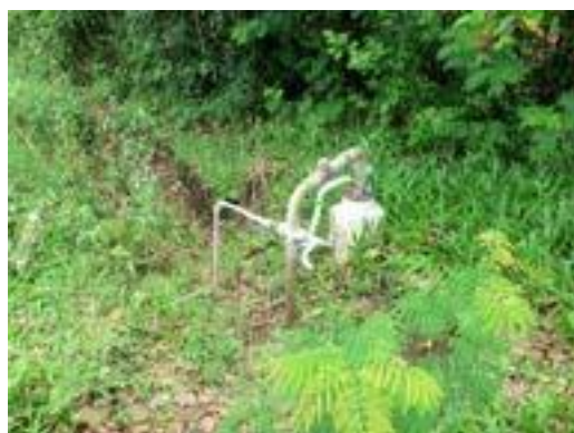
Figura 25 – Detalhes do Poço e aplicação de produtos químicos - Rua Guilherme Jacobs
