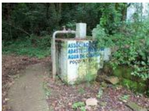
Figura 22 – Instalações do Poço de captação de água subterrânea - Praça
